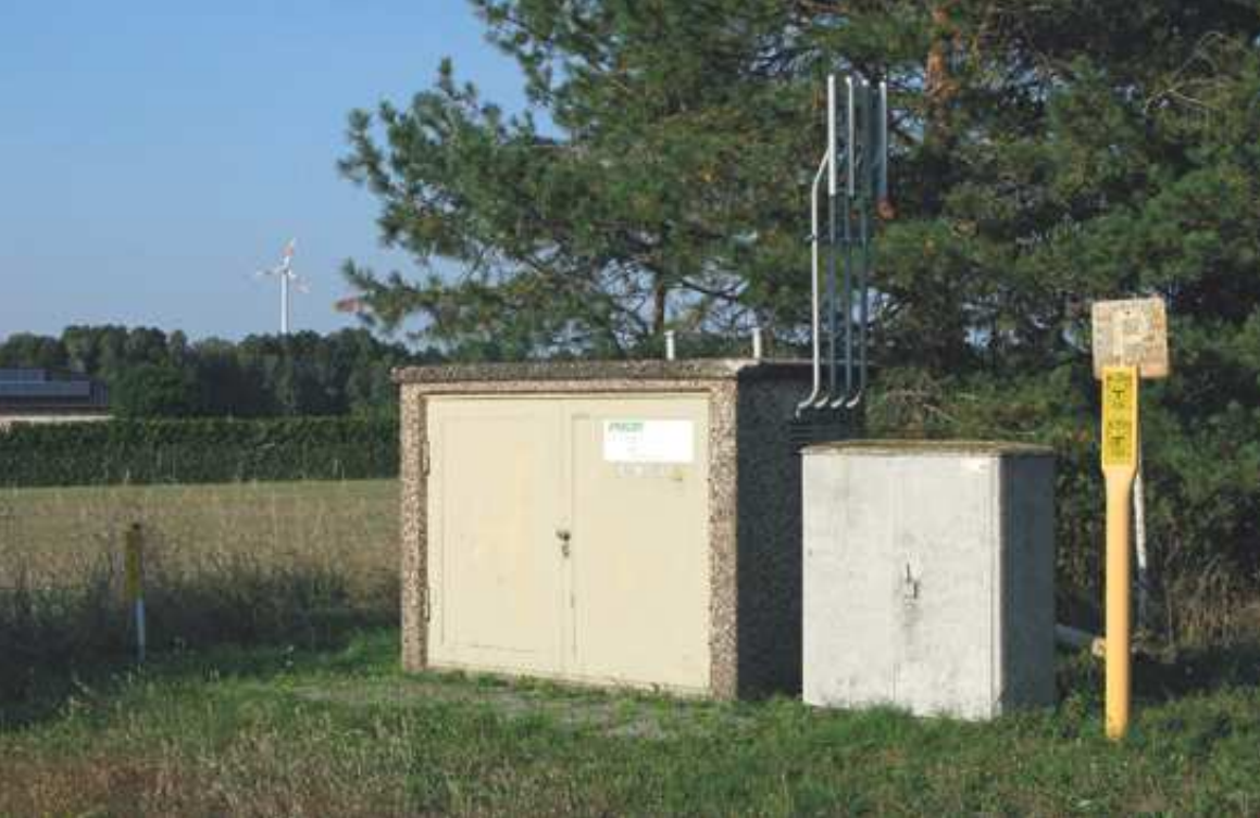
Abb. 2: Gasdruckregel- anlage in Schoppsdorf mit einer von zahlreichen Windkraftanlagen im Hintergrund
