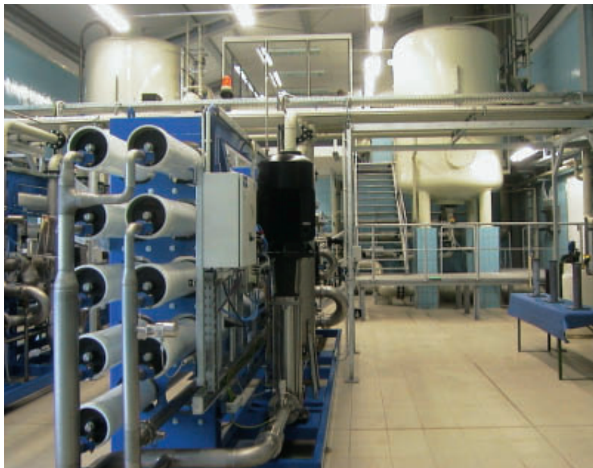
Abb. 2: Neue Trinkwasseraufbereitung Bad Dürkheim mit UO-Straße 1 im Vordergrund
