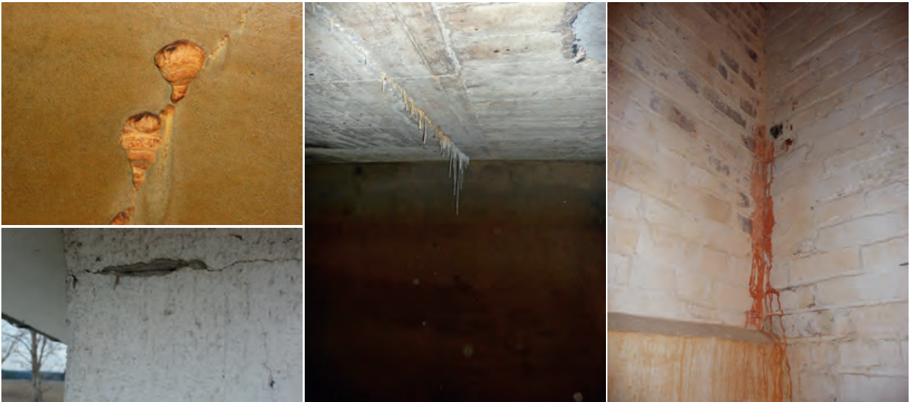
Abb. 1: Beispiele für Undichtigkeiten in Behältern
