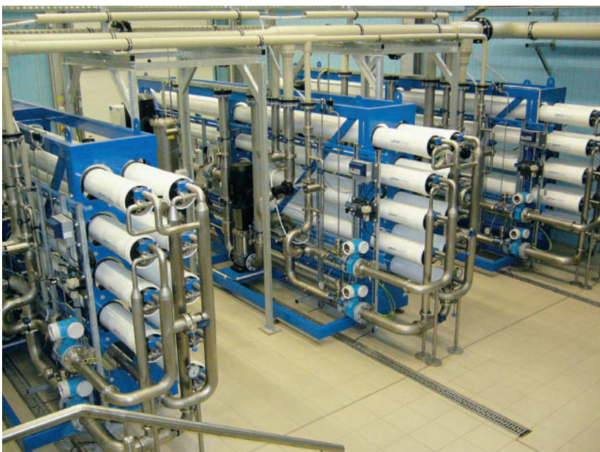
Abb. 2: Großanlage zur Umkehrosiose-Entsalzung in Bad Dürkheim
