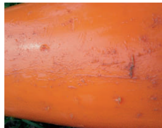
Abb. 8: Rohr NW110 mit Beschädigungen von Gleisschotter
