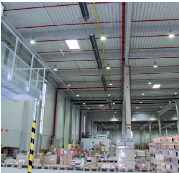
Abb. 2: Beispiel für Dunkelstrahler-Installation in einer Lagerhalle
