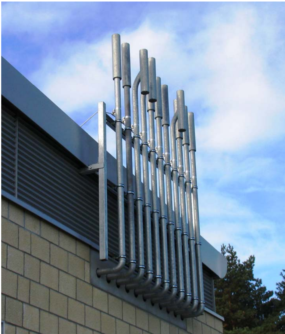
Bildunterschrift: Ausbläser an einer Gas-Druckregelanlage. Quelle: VNG
