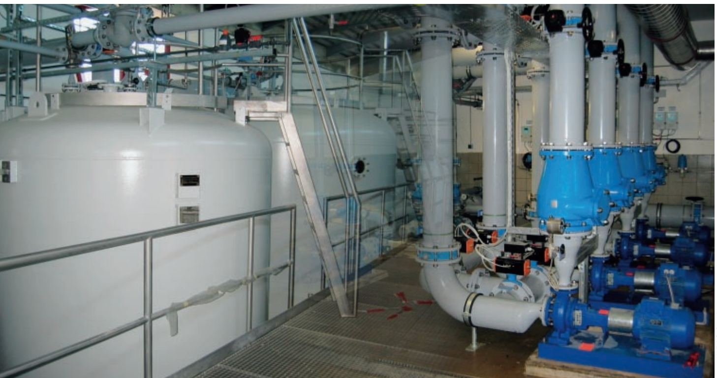
Ionenaustauscher-Anlage zur Enthärtung nach dem CARIX-Verfahren.
