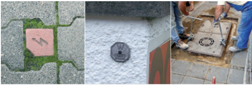
Abb. 3: Unterschiedliche Kennzeichnungen weisen auf Leitungen hin – v. l. n. r.: Stromleitung, Wasserhausanschluss, Kabelschachtabdeckung Telekommunikation
