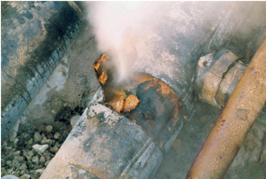
Abb. 4: Verbrühungsgefahr durch heißes Wasser aus einer Fernwärmeleitung: Selbst wenn nur die Isolierung beschädigt wurde, besteht bei ausbleibender Reparatur die Gefahr der Korrosion der Stahlmediumrohre durch eindringende Umgebungsfeuchte.
