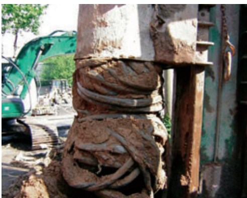
Abb. 2: Bei einer Bohrung für ein Fundament wurde eine Telekommunikationsleitung erfasst und auf mehrere Meter herausgerissen
