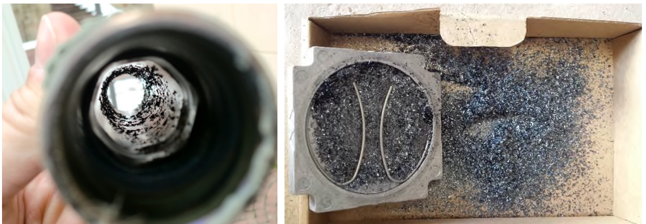
Abbildung 1: Innenansicht Kupferleitung mit Ablösung der Sulfidschicht (links); Partikel aus dem Filter einer Gasdruck-Regelarmatur (rechts)
