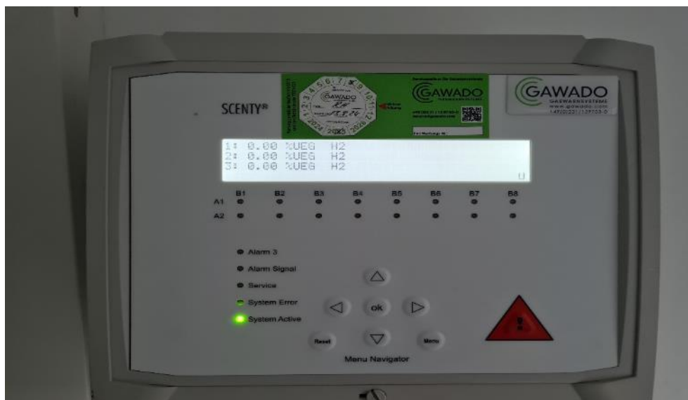
Abbildung 3.14: Tableau der Gaswarnanlage
