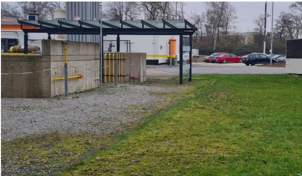
Abbildung 3.8: Leitungsführung unterirdisch zum Demo-Haus und HySpeed-Forschungscontainer
