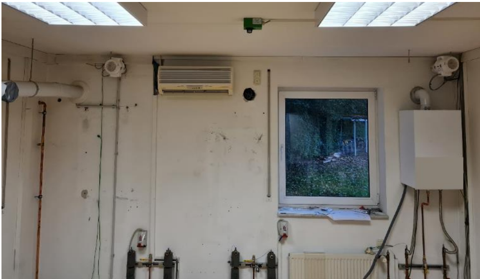
Abbildung 3.13: 100-Vol.-%-H 2 -Gerät/ Abluftventilatoren und Gaswarnsensor
