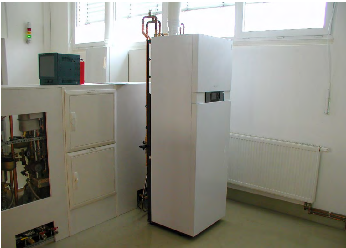
Abbildung 4-9: Standort der VITOSORP 200-F im Demonstrationszentrum
