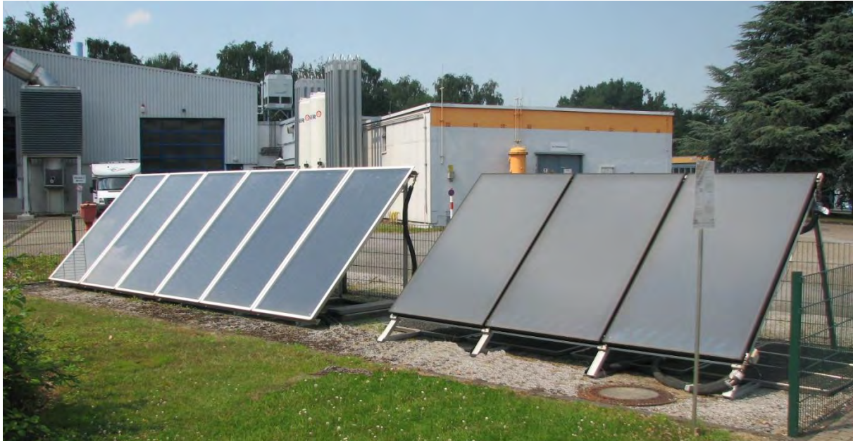
Abbildung 10-4: Solarthermiemodule für die Brennwert plus Solar- und Gaswärmepumpenanlage
