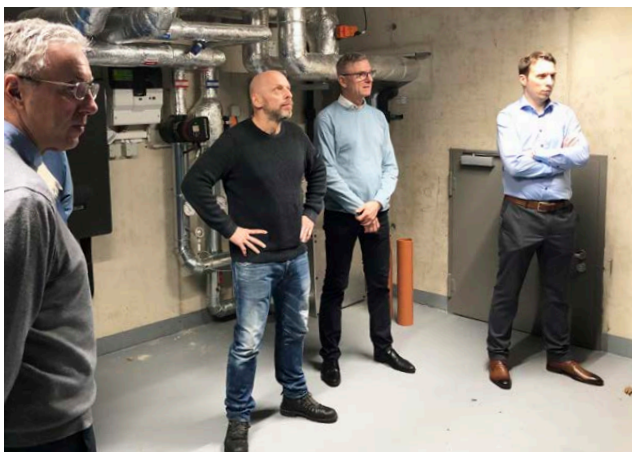
Vorstandsmitglieder besichtigen die Installationsanlagen des Wüsten- und Urwaldhauses DANAKIL in Erfurt
