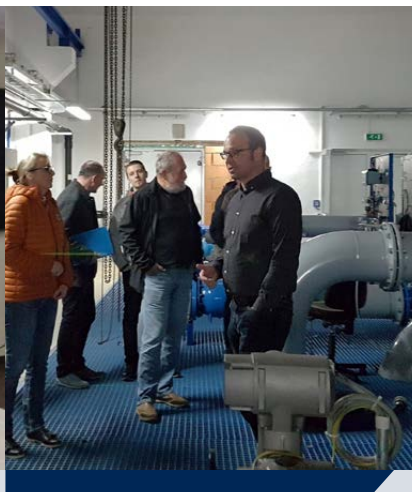
Herr Richter vom Wasserzweckverband erläutert die Aufbereitungstechnologie
