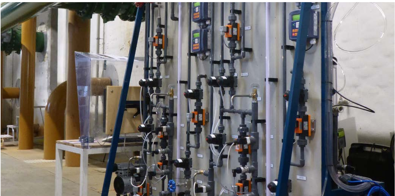
Vor-Ort-Versuche zur Membranfiltration mit einer zweistraßigen Versuchsanlage der Forschungsstelle, zwei Membranmodule (weiß) senkrecht eingebaut (Quelle: DVGW-TUHH)
