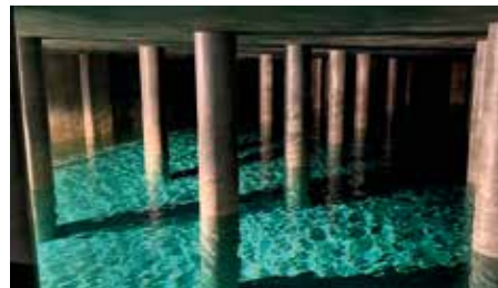
Wasserkammer Wasserwerk Kylltal
