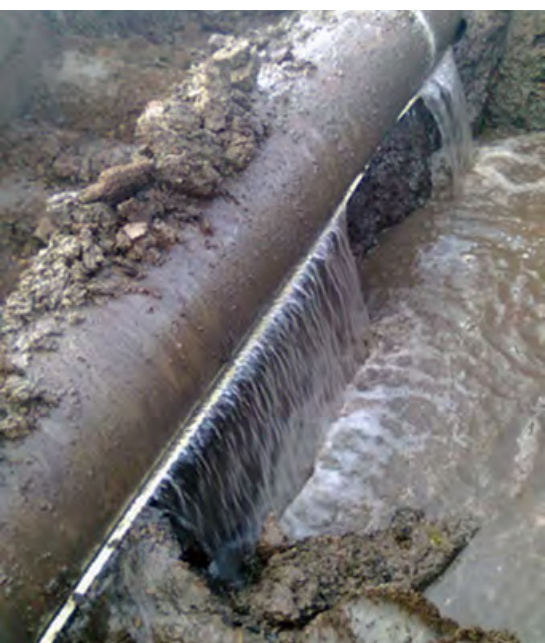
Abb. 2: Ein langer, durch RCP entstandener Riss
