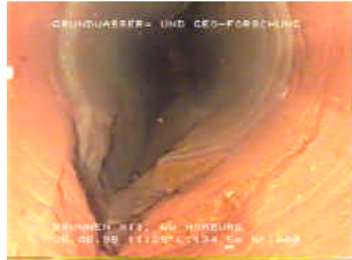
Bild 11: Augenförmiger Brunnenquerschnitt als Folge von Ausbrüchen an einer durchschlagenden Kluft in ansonsten stabilem Sandstein.
