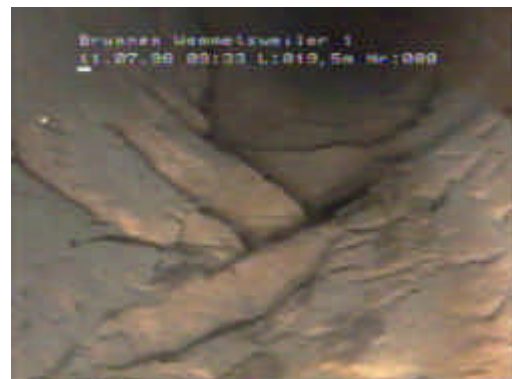
Bild 12: Zerschierung des Gebirgsverbandes im karbonischen Grundwasserleiter durch sich kreuzende Kluftsysteme. Wiederholte Abrutschungen infolge relativ flachen Einfallswinkels der Scherflächen.
