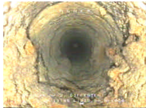
Bild 4: Veränderung der Radialsymmetrie durch karbonatische Aufwachsungen führt beim Pumpenein- und -ausbau und massiven Problemen.
