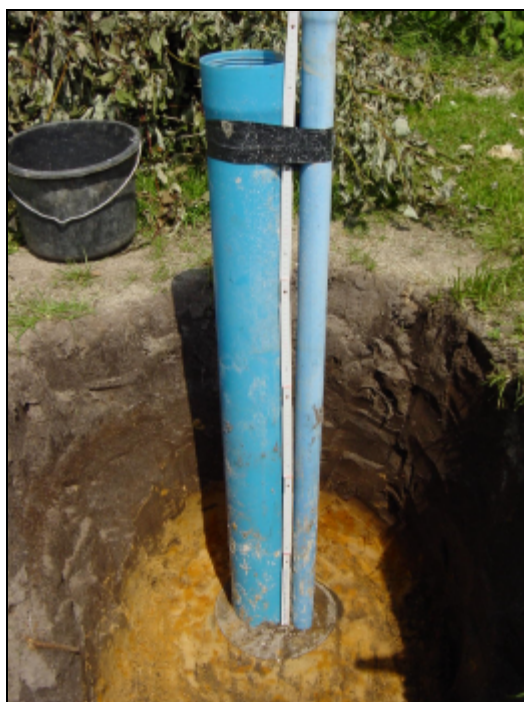
Bild 8: Freigelegte Oberkante der Verpressmasse nach Abschluss der beobachteten Setzungen am Beispiel von VB 3
